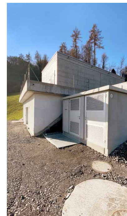
Die neu erstellte Trafostation beim Reservoir Arschad
