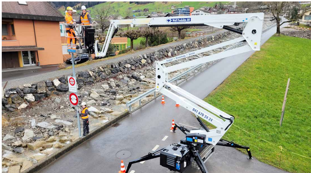
Die neue Hebebühne hat sich bereits bestens bewährt.
