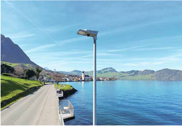
Das gesamte Gemeindegebiet ist mit neuen, energieeffizienten LED-Leuchten ausgerüstet.
